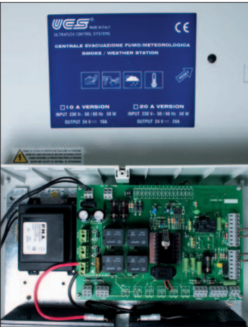
ПОДСТАНЦИЯ EFC/МЕТЕО 10-20 A Подстанция EFC 10A - КОД 40731R Подстанция EFC 20A - КОД 40732S
